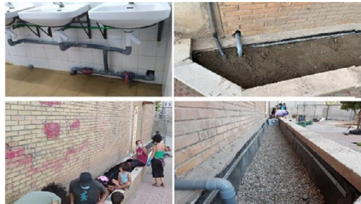
Figura 2.5 - Obras de depuración de aguas grises en el CEIP Mar Mediterráneo de Almería Fuente: Diario de Almería
