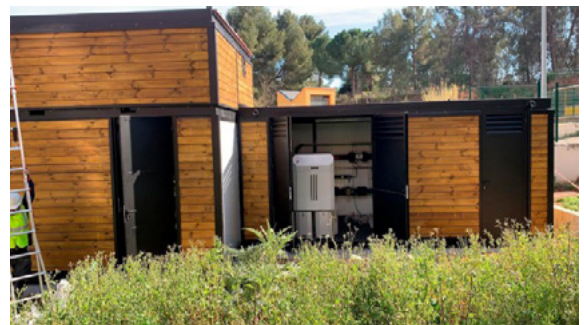
Figura 1.4 - Caldera de biomasa CEIP Àngel Guimerà. Fuente: Termosun
